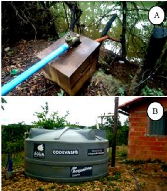
Figura 4 – Formas de abastecimento de água na Comunidade de Poções. A) Captação de água do Rio Cachoeiras. B) Captação de água de chuva através de caixas d'água com capacidade de 16 mil litros.
