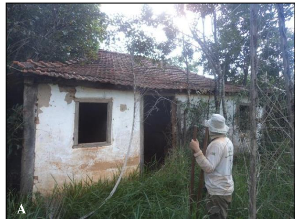
Figura 7: Sítio Histórico Casa Velha: fachada frontal (A) e vista parcial da parede de pau-a-pique (B, C)
