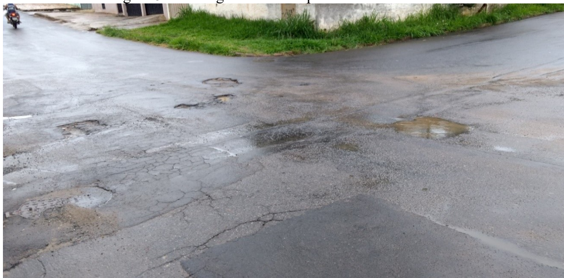
Figura 5 - Patologias da via no ponto de cota mais baixa
